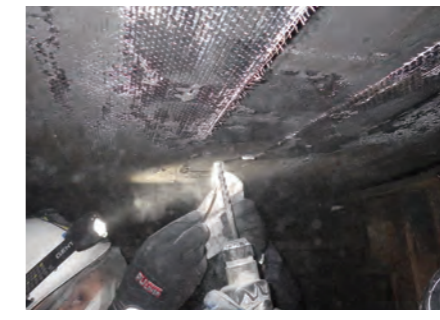
火災により被害を受けた RC 床版 (ドリル法による中性化測定)
